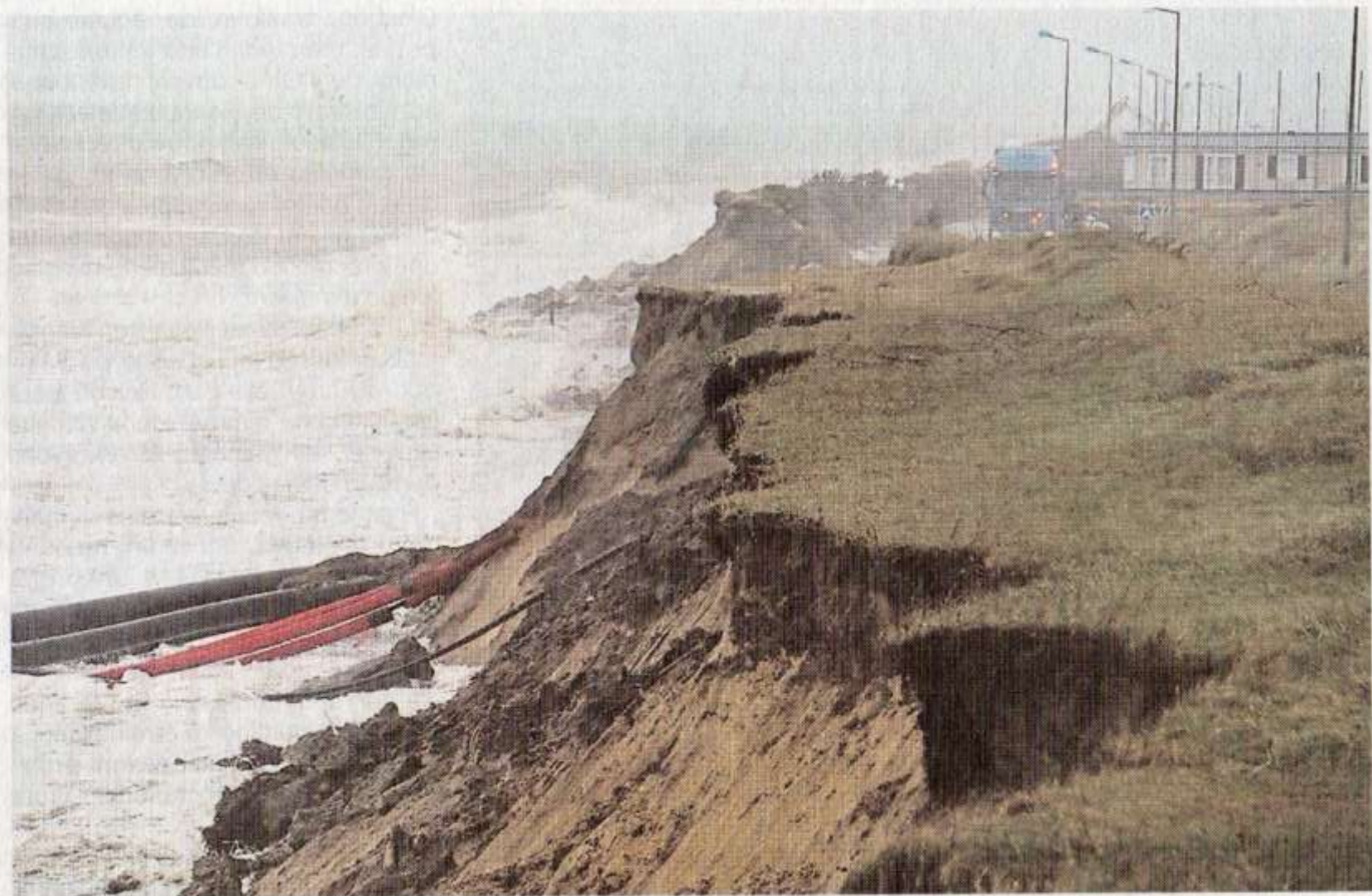
La tempête « Inès » a fait de nouveaux dégâts à Gouville-sur-Mer, jeudi, tandis que les travaux d'urgence se poursuivaient devant le camping.
